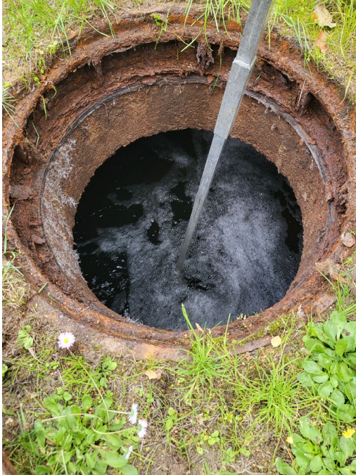
Bild 5: Utloppsbrunn och normalt vattenflöde
